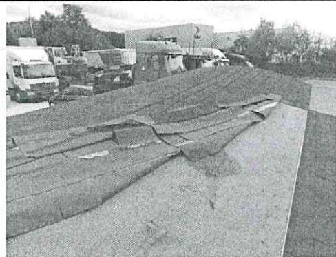
Dach teilweise lose
