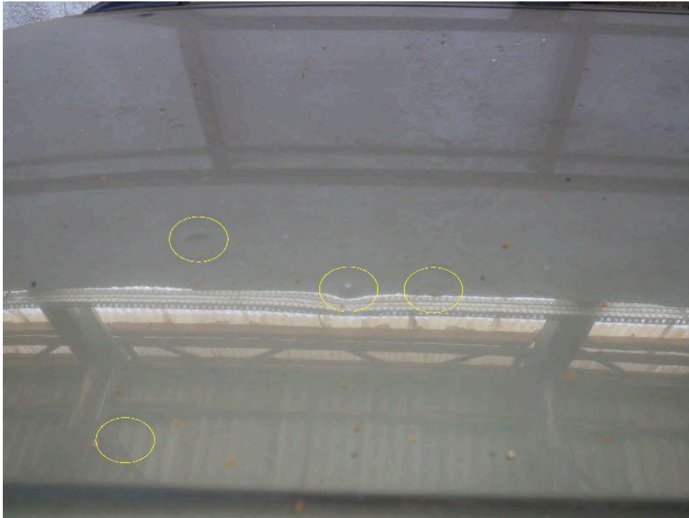
Bild: 21 Dellen Dach
