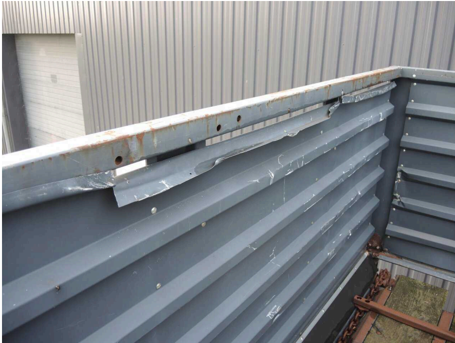
Bild 15 Aufbau Bordwand verformt
