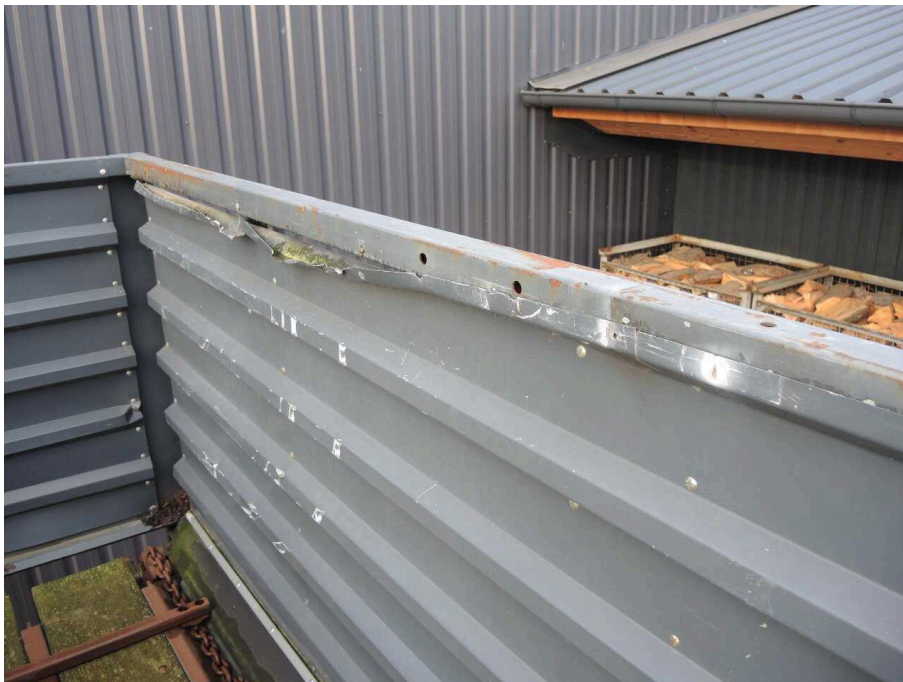
Bild 14 Aufbau Bordwand verformt
