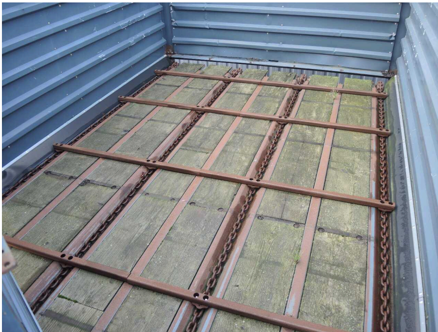
Bild 13 Aufbau Bordwand verformt
