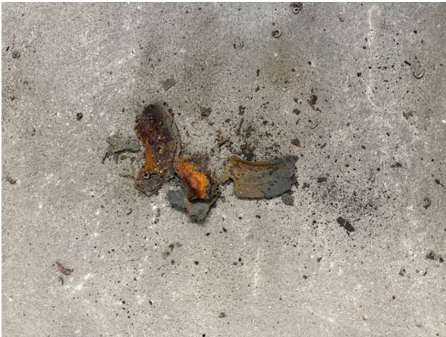
Bremsankerbleche beim Anfahren abgelöst
