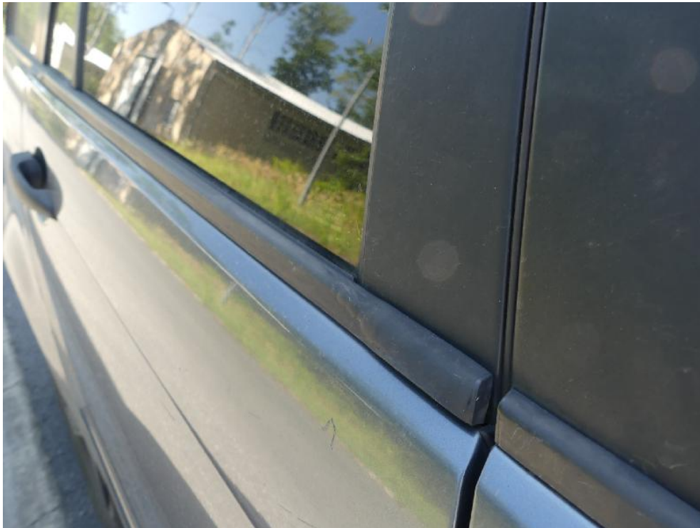
Bild: 93 Abdichtleiste Fondtür rechts beschädigt.
