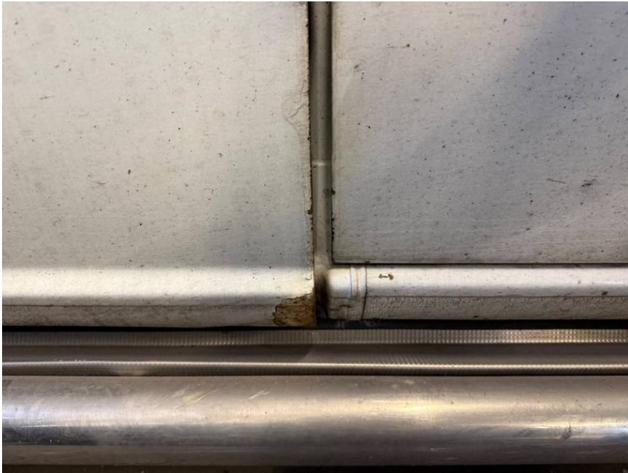
Korrosion rechte Schiebetür
