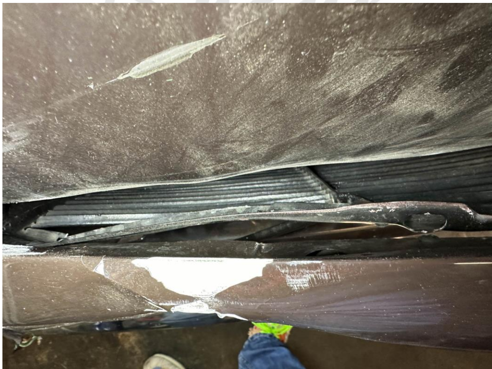
Die Verstärkung ist stark gestaucht
