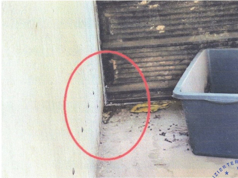
Bild 6 Angegriffene Bodenplatte und Seitenwand hinten rechts
