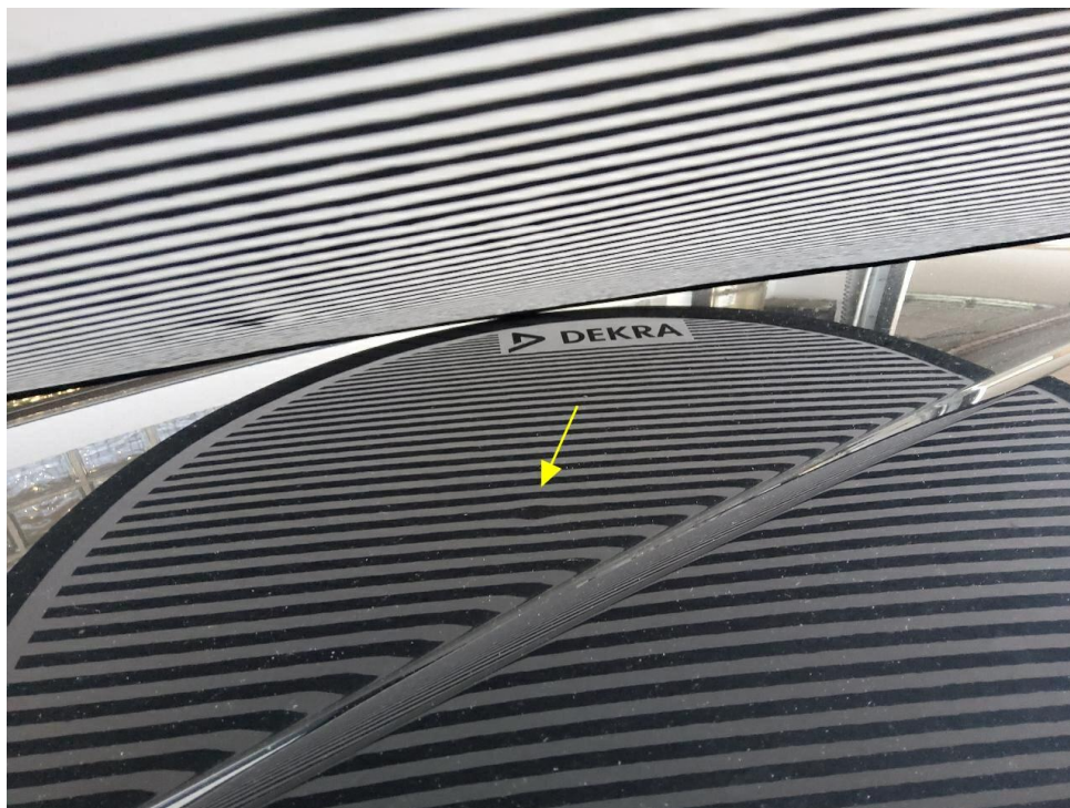
Bild 15 : Dach mehrfach eingedellt
