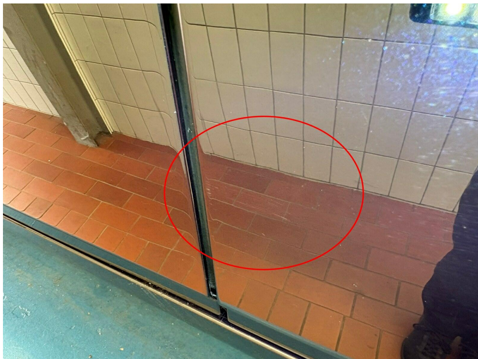
Bild 43 : Tür vorne rechts verschrammt
