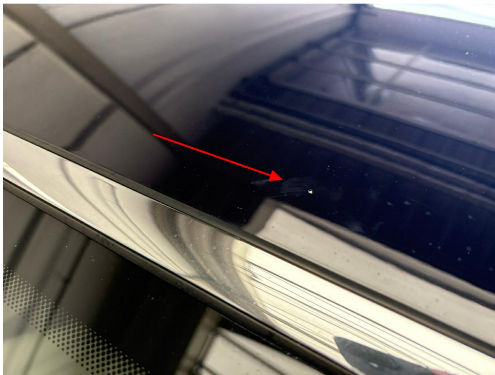
Bild 29 : Steinschlag Dachkante vorne
