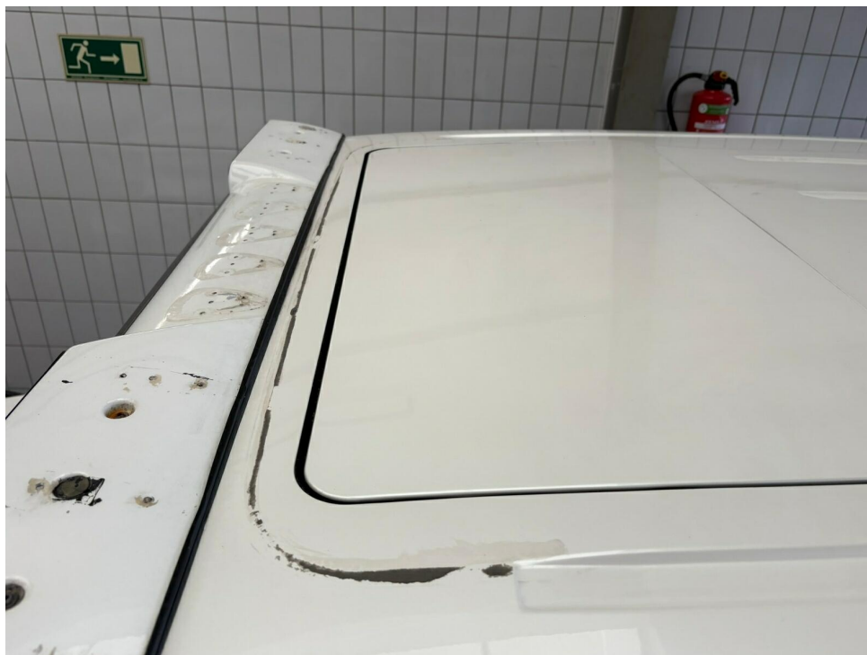
Bild 33 : Dachspoiler/Windabweiser Schiebedach fehlt
