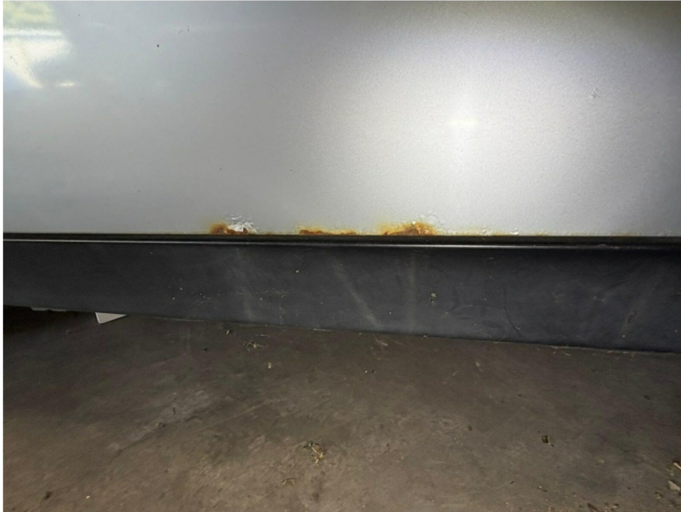
Bild 13 : Tür links korrodiert
